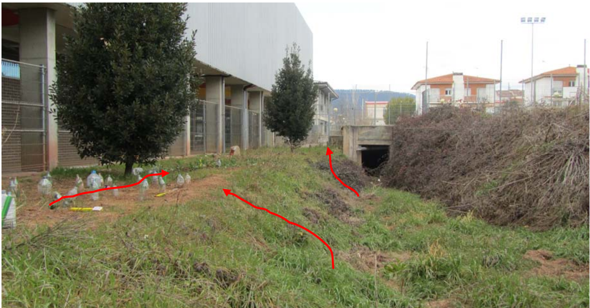
Figura 38. Imatge del canal del torrent de l'Institut, just per sobre l'entrada al canal soterrat. (Les fletxes vermelles indicarien possibles punts de desbordament).
